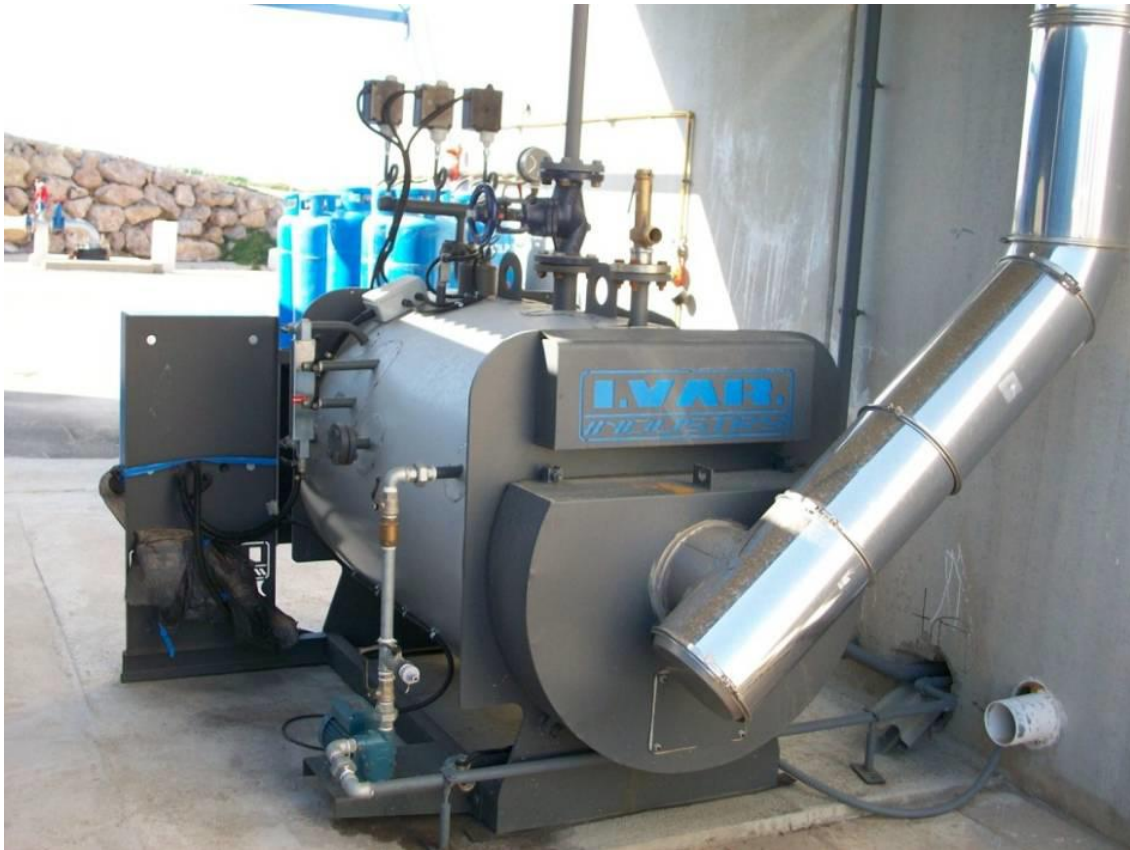
Figura 5: Caldera y balas de propano.
